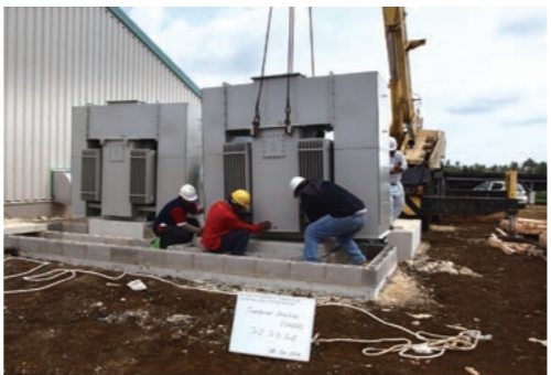
各地域に効率よく送電するために必要な変圧器の役割を果たすトランス盤を設置
