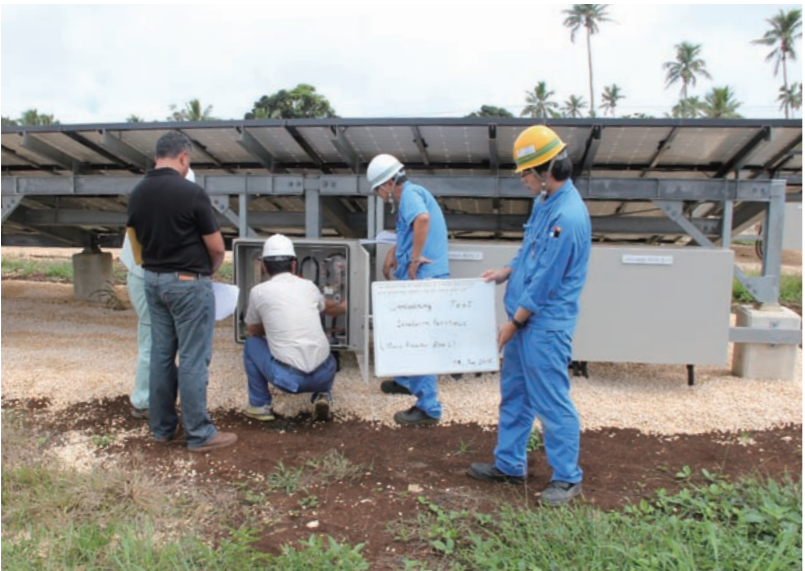
太陽光パネルの配線状況を現地の作業員と共に確認しながら試運転
